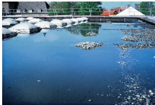
Abb. 3.1: Stehendes Wasser auf einem 0°-Dach
